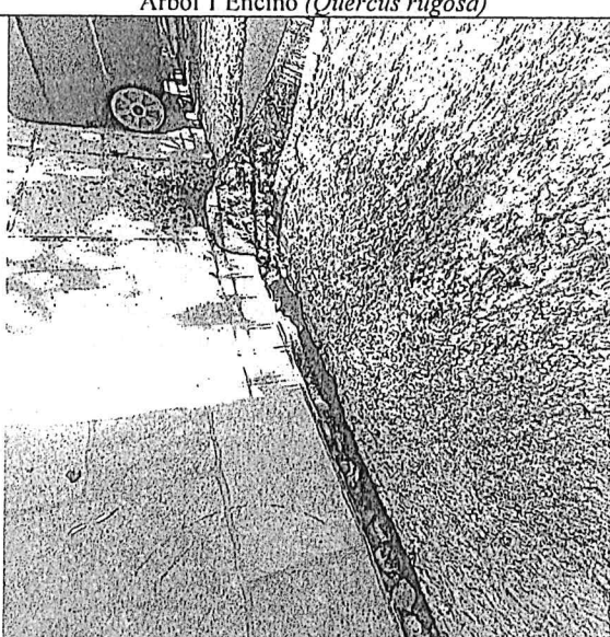
Áfektionen en barda perimetral
