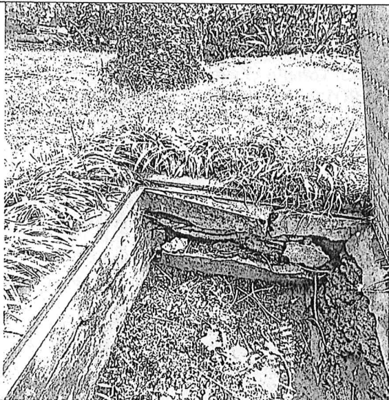
Afectaciones en resumidero
