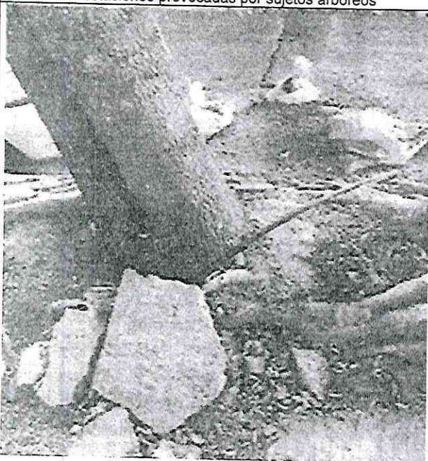
Afectaciones provocadas por sujetos arbóreos
